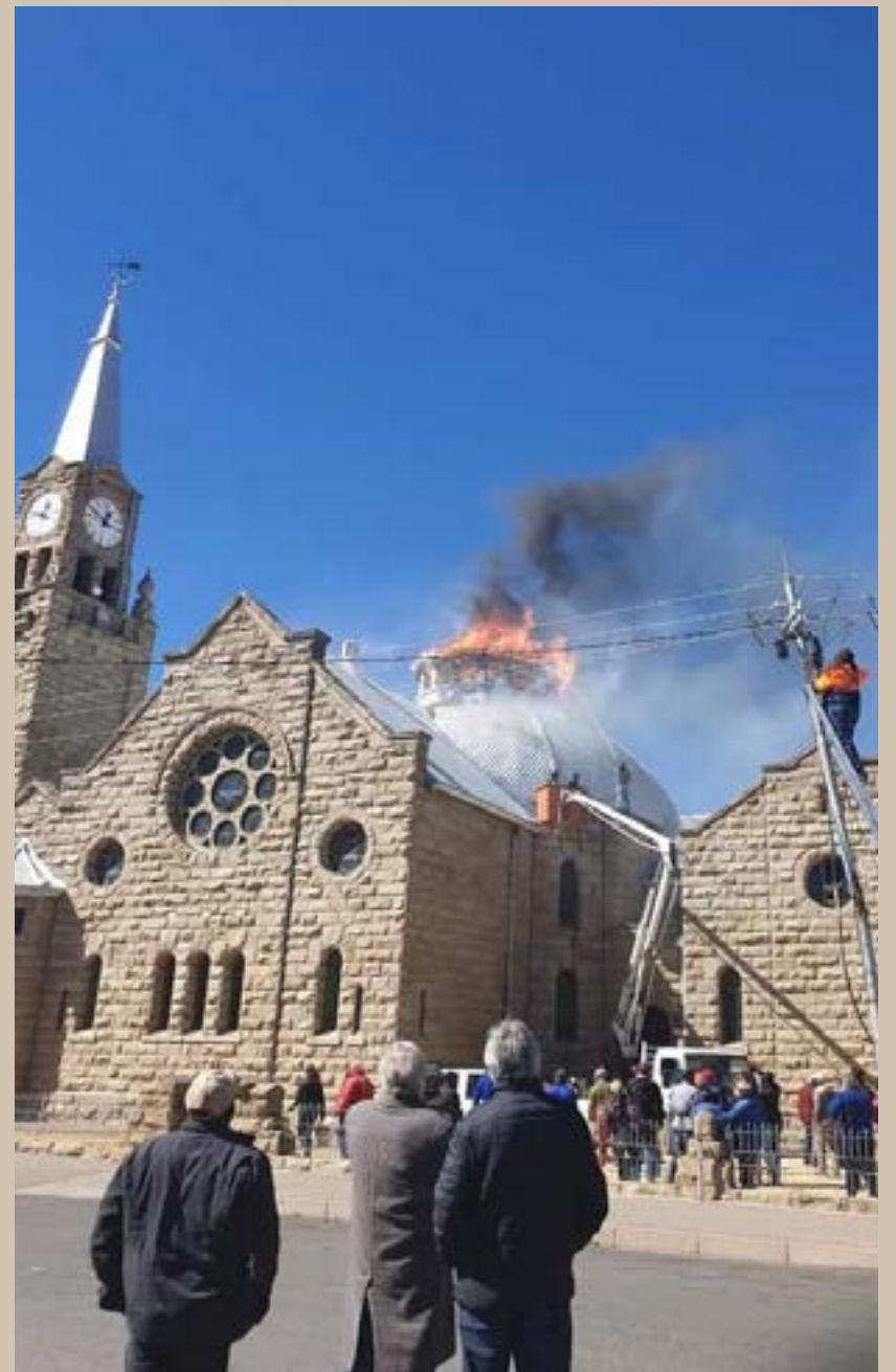
'n Brand wat glo in die koepel van die NG Kerk op Burgersdorp in die Oos-Kaap ontstaan het, het groot dele van die gebou in puin gelê ondanks pogings deur die gemeenskap om die vlamme te tem.
